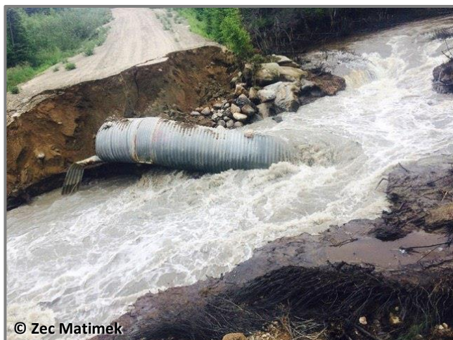
Figure 1 : Exemple d'un lessivage suite à un bris de ponceau.
